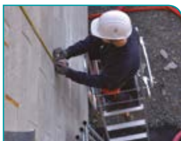
Protection de l'opérateur par garde-corps et chaînettes.
